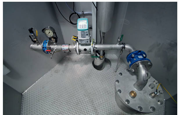
Installation mit Brunnenkopf
